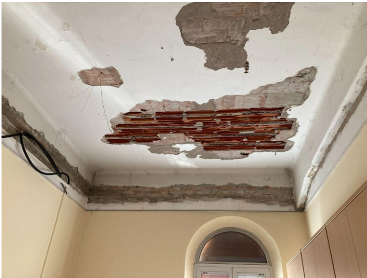
Foto solaio di 1° impalcato oggetto di sfondellamento
